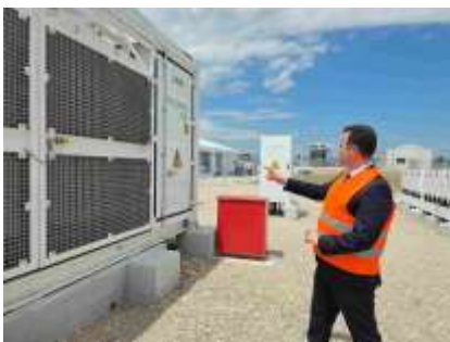
ロヴェチの BESS を視察するスタンコフ大臣
